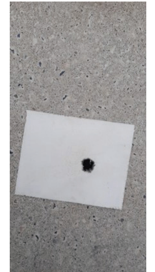
Breng tape aan en doorboor die zodat de herstelpasta iets hoger kan worden aangebracht
